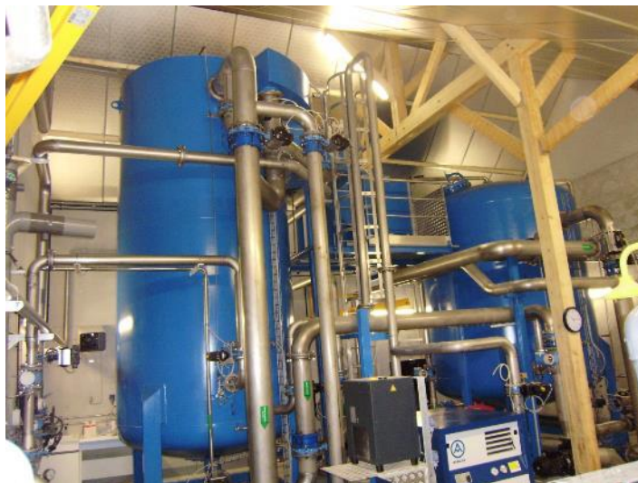
Figure 6 : Photo de la station de traitement – A gauche, le Nitrazur ® et à droite, le Carbazur ®
